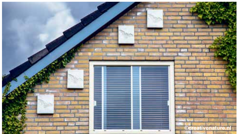
Fledermauskasten an der Fassade eines Hauses als Ersatz wegfallender Strukturen.
