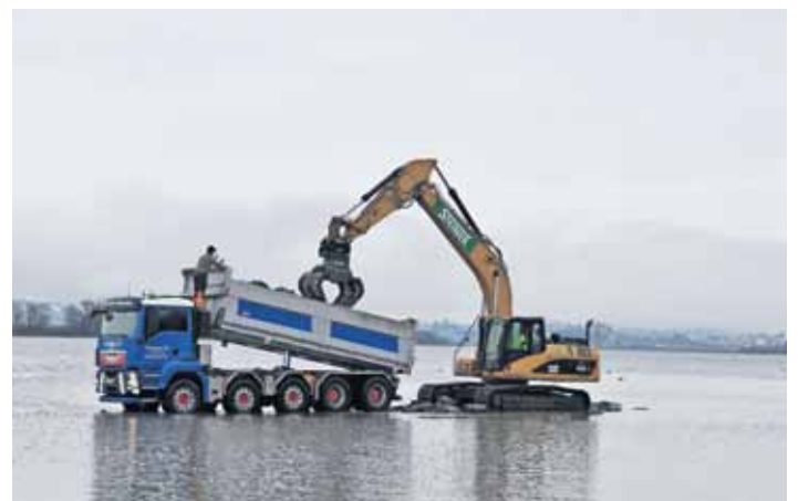
Lastwagen und Bagger fahren auf dem vorgeschütteten Riff, welches dann das neue Flachufer vor Wellen schützt.
